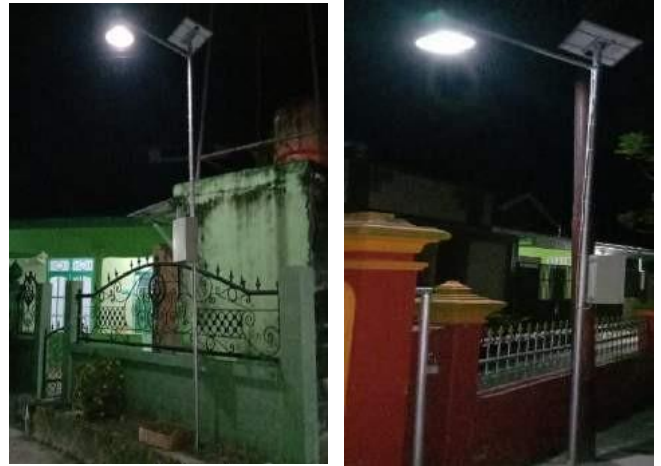
Gambar 6. Lampu penerangan berbasis panel surya menyala di 2 lokasi pemasangan
