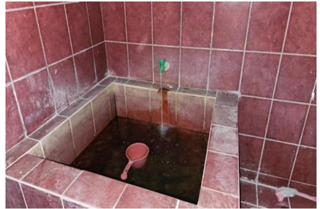
Gambar 3. Kondisi toilet gedung sekretariat LPM yang telah dialirkan air bersih
